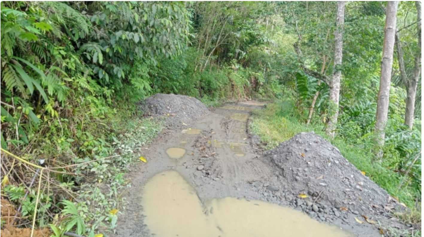
Kondisi Jalan Poros Desa Kidupen - Lau Lingga Kecamatan Juhar, Kabupaten Karo, Jumat (23/12-2022)
